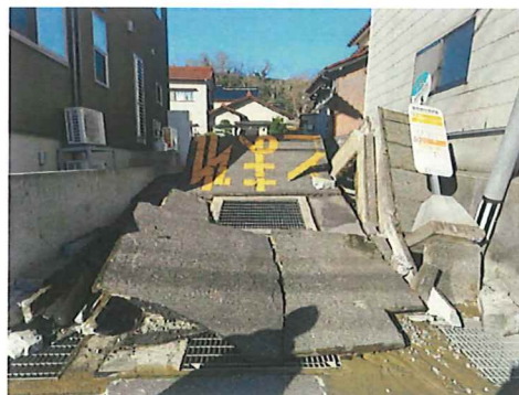
道路（町道）が隆起した状態
