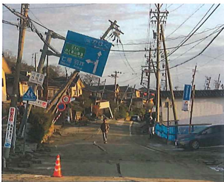
道路（県道）が隆起した状態
